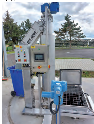
W tym miejscu z głównego strumienia ścieków usuwane są największe odpady
