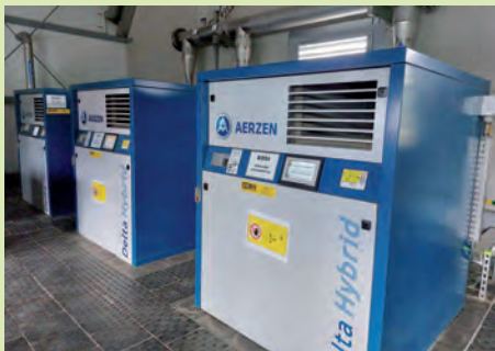
Potężne dmuchawy dostarczają powietrze potrzebne do biologicznych procesów oczyszczania
