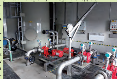
Pompy tłoczą oczyszczoną już wodę do „odbiornika”, albo do urządzeń oczyszczalni
