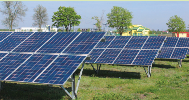
Dotychczas największą instalacją PV była ta w pobliżu Żłobnicy
