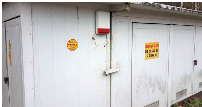
Zasilanie gminy w gaz ziemny odbywa się poprzez tę stację pomiarową
