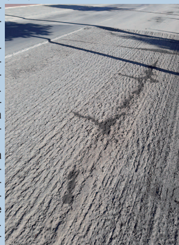
Sfrezowana nawierzchnia ściekalna w miejscu wystąpienia spękania podłużnego. Ciemniejszy ślad pokazuje miejsca, w których woda przenika do niższych warstw (frezowanie zostało wykonane dwa dni po opadach deszczu).
