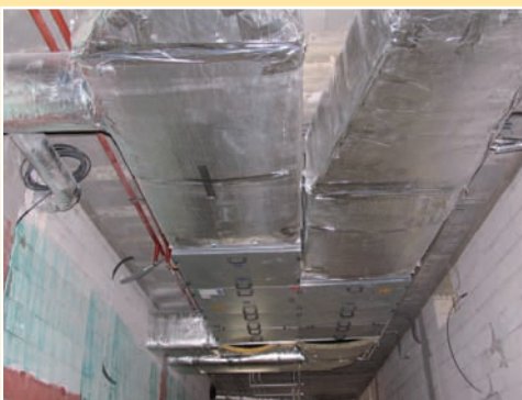
Urządzenia i przewody klimatyzacyjne zamontowane pod stropem
