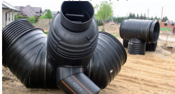
Takie skomplikowane konstrukcje skutecznie łączą w całość sieć podziemnej kanalizacji
