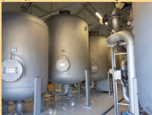
Część urządzeń we wnętrzu wyremontowanej stacji
