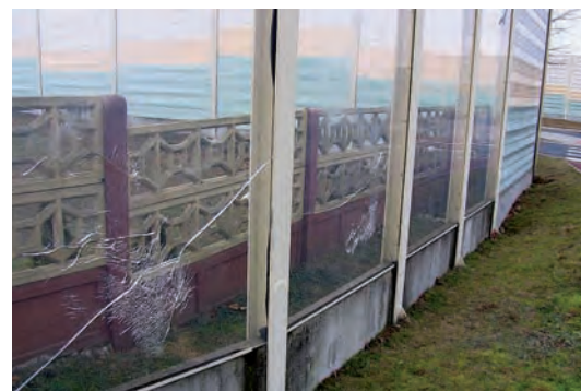
Zniszczone przez wandalów stare ekrany
