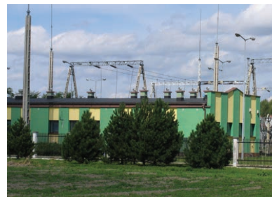
Stacja elektroenergetyczna w Kleszczowie
