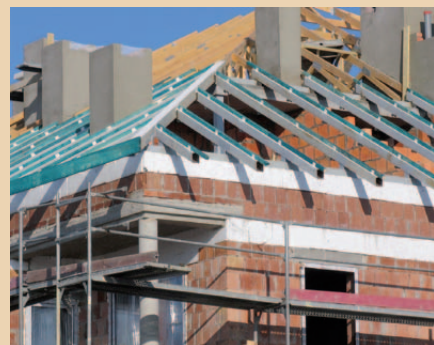
Konstrukcja dachu wykonana jest w znacznej części z elementów metalowych, a w tylko w części z drewnianych krokwi.
