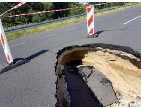
W miejscu, gdzie przebiega przepust, zapadła się jezdnia
