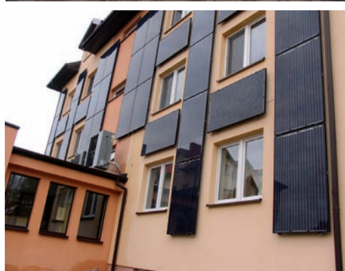
Panele fotowoltaiczne na osiedlu „Łuszczanowice”
