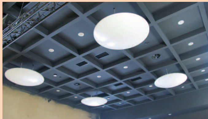
W sali widowiskowej zainstalowano zróżnicowane oświetlenie
