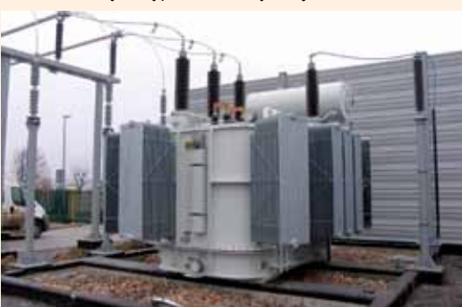
Potężny, 50-tonowy dławik, zamontowany w GPZ w Kleszczowie
