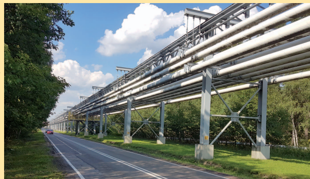
Przebieg nowej drogi trzeba będzie pogodzić z instalacją, która transportuje popiół na składowisko
